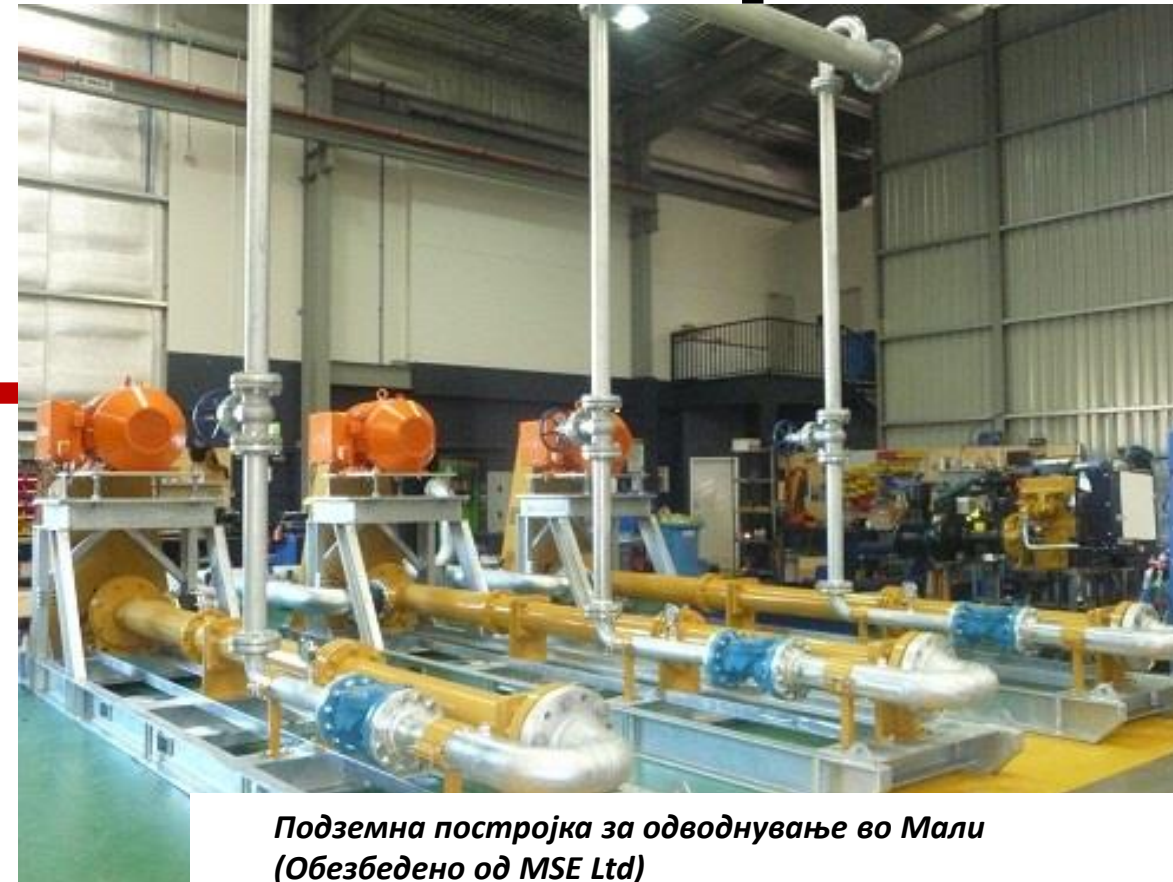
Подземна постројка за одводнување во Мали (Обезбедено од MSE Ltd)
